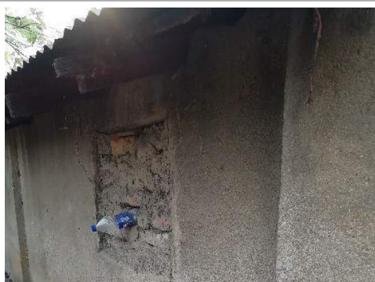
Before)窓の様子
