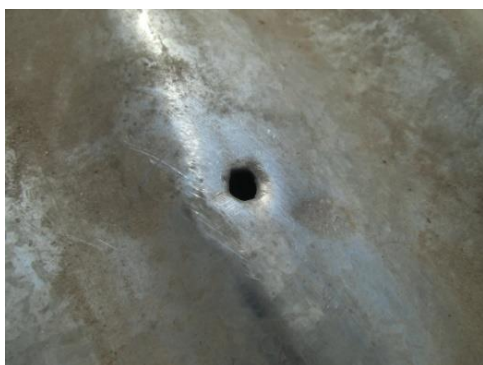
(屋根に空いている穴)
